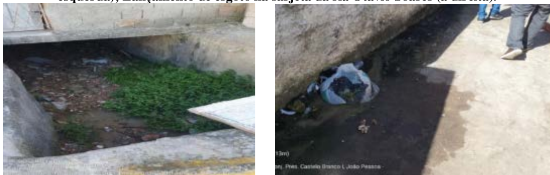
Figura 138 –Lançamento de esgoto em galeria de drenagem pluvial na Rua São Cassimiro (à esquerda); Lançamento de esgoto na sarjeta da ria Otavio Soares (à direita).
