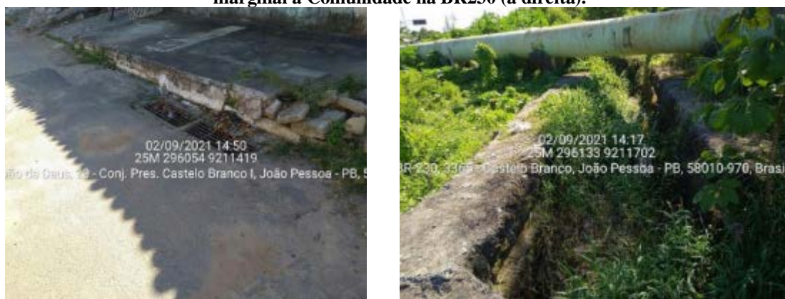
Figura 139 - Boca de Lobo encontrada na Rua João de Deus (à esquerda); Canal de drenagem marginal a Comunidade na BR230 (à direita).
