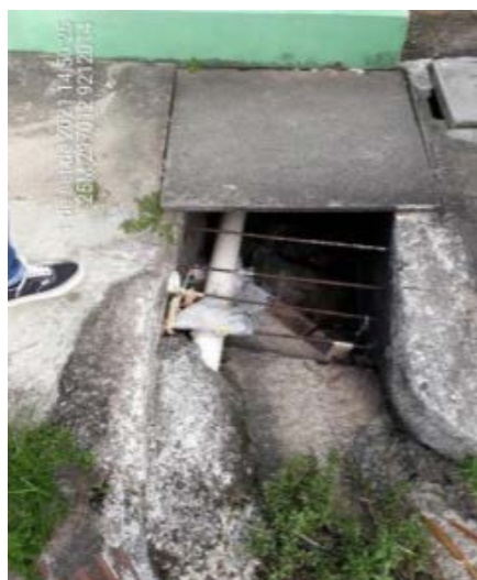
Figura 147 - Ligação clandestina de esgoto para a rede de drenagem pluvial
