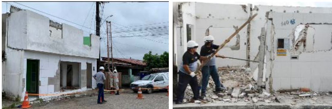
Figura 142 - Demolições emergenciais de habitações em área de alto e muito alto risco geológico.
