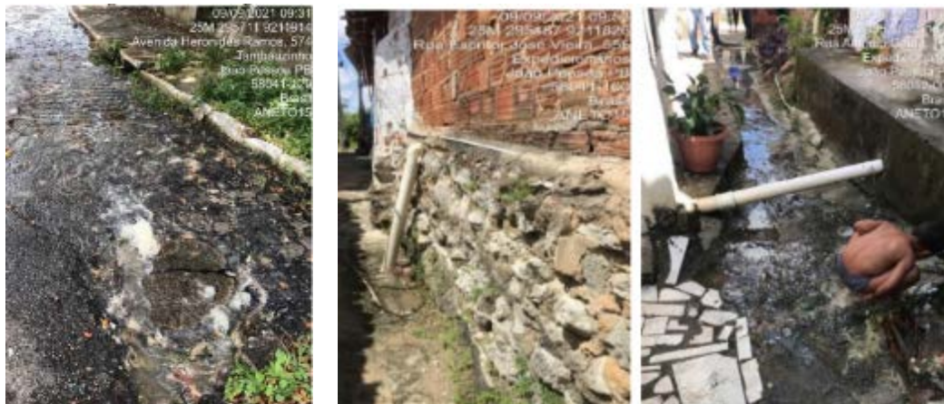
Figura 130 - Problemas de saneamento identificados na Cafoko Liberdade.
