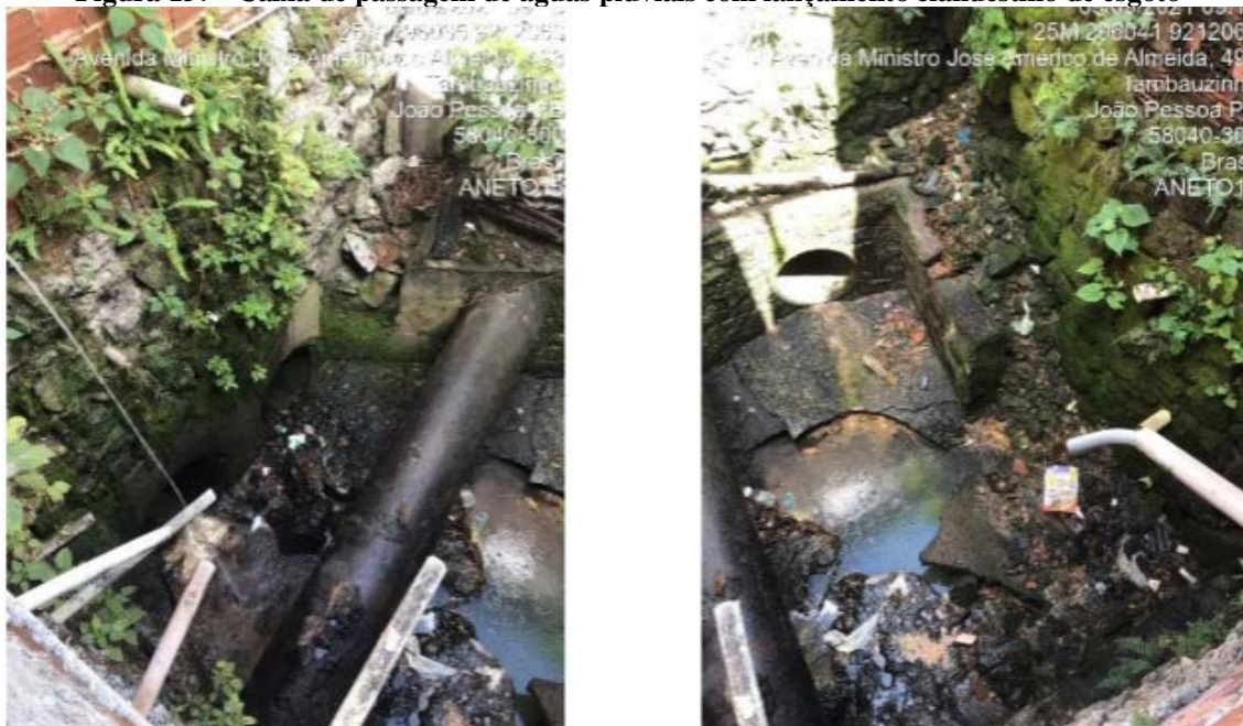
Figura 157 - Caixa de passagem de águas pluviais com lançamento clandestino de esgoto
