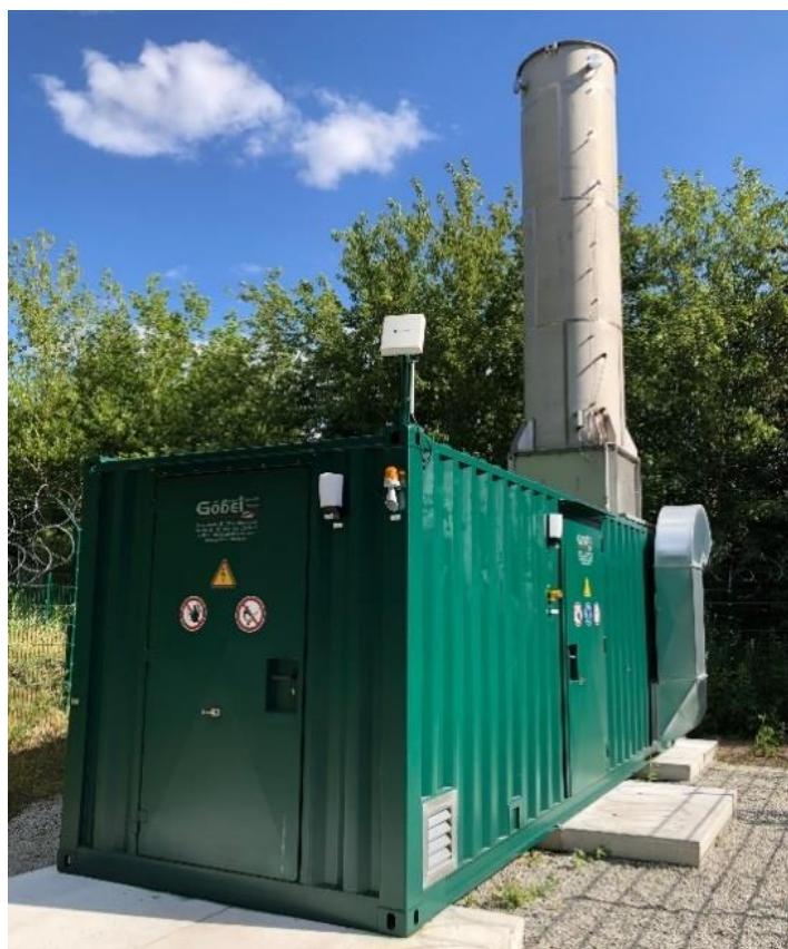
Figura 4.25 – Foto de um módulo compacto de medição, regulação e queima centralizada
